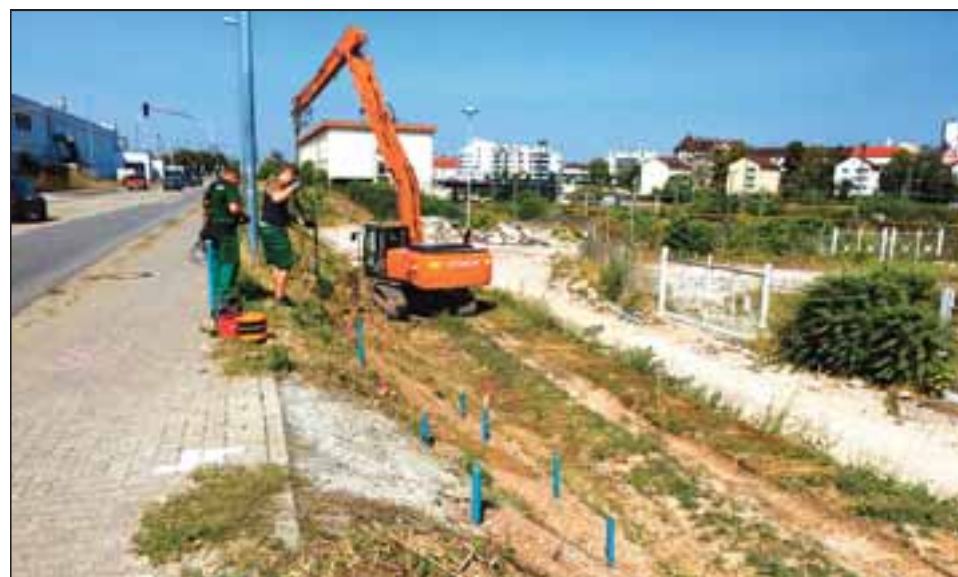
Bevor der Czernyring in der Bahnstadt ausgebaut werden konnte, untersuchte eine Spezialfirma mit Sondierbohrungen den Untergrund nach Kampfmitteln. Foto: privat
