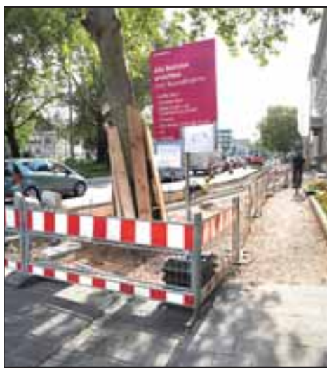
Die Bauarbeiten für den neuen Radweg am Adenauerplatz sind in vollem Gange – sollen aber noch bis Ende November dauern. Foto: lej
